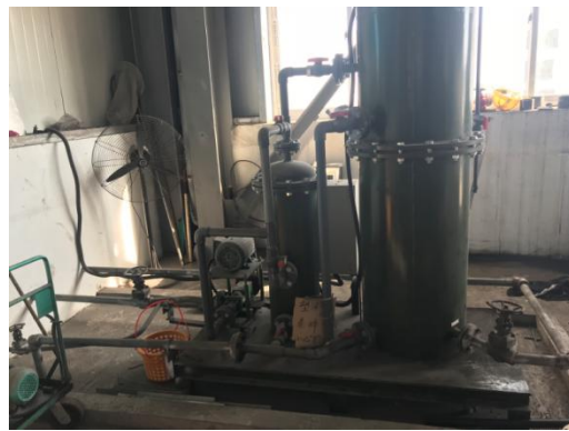
图 4-3 机修房油水分离器
