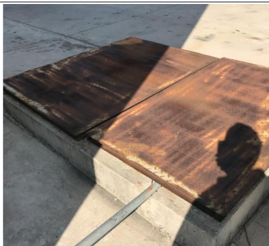
图 4-4 机修房隔油池
