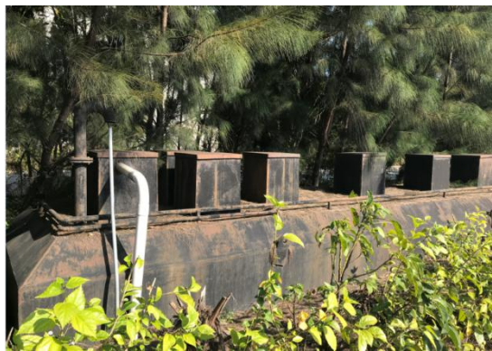
图 4-2 一体化生活污水处理设备
