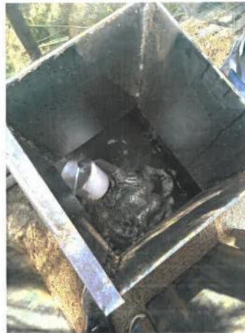
污水处理设施出口
