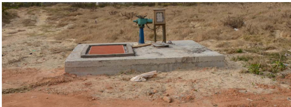
连接场内外两个事故池闸门
