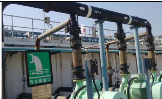
15 含盐污水排放管道
