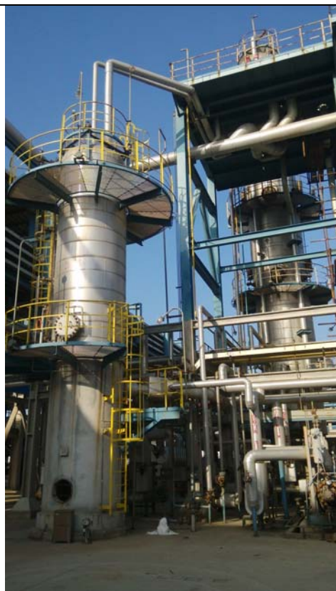
2 加氢裂化 LGP 脱硫装置
