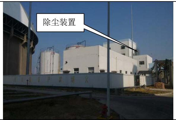
6 动力车间转运站除尘装置
