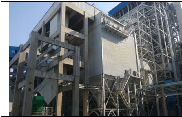
5 动力车间烟气处理—电除尘装置
