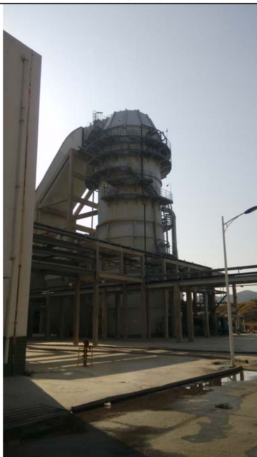
3 动力车间烟气处理—脱硫塔
