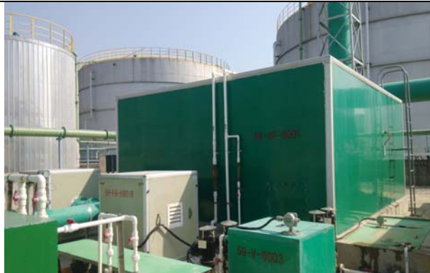
13 污水处理站除臭装置
