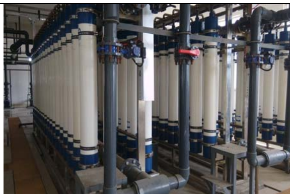
12 含盐污水处理系统—UF 膜
