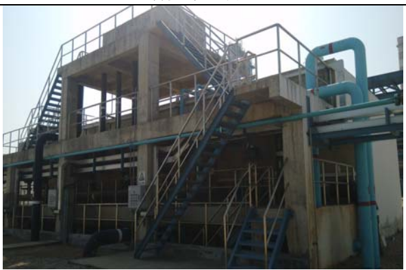
10 含油污水处理系统—BAF 池
