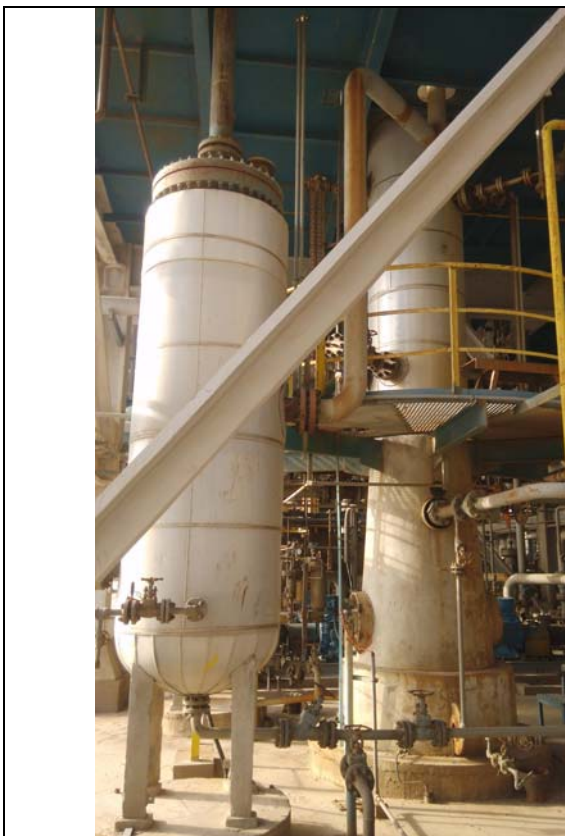
1 加氢裂化干气脱硫装置
