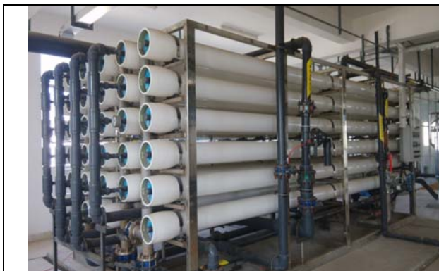
11 含盐污水处理系统—RO 膜
