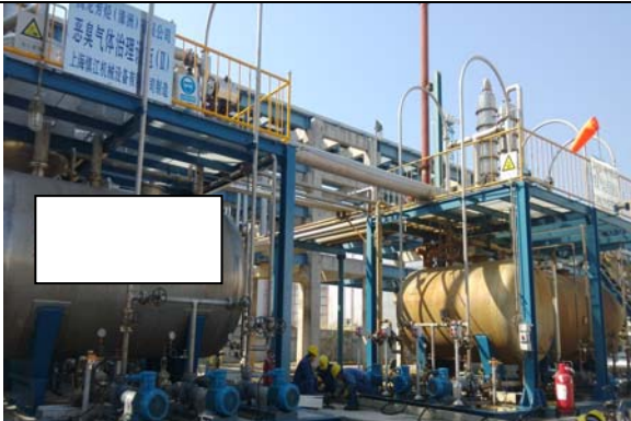
14 储罐除臭装置
